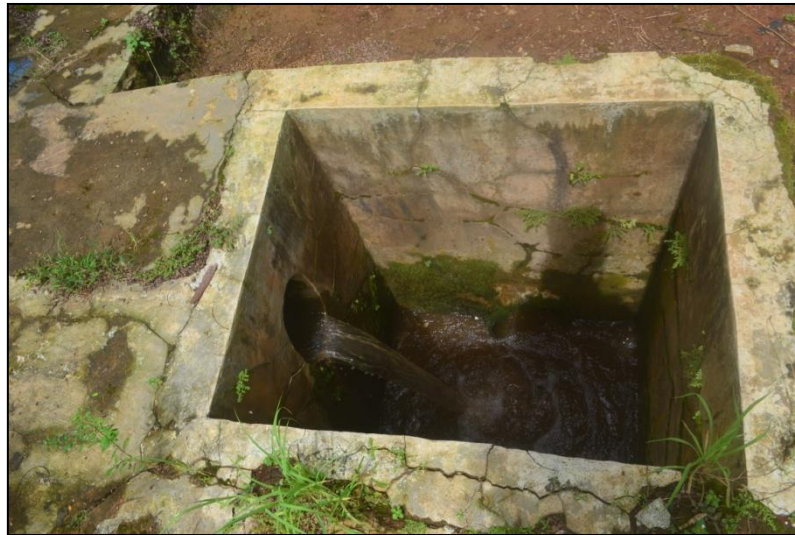
Gambar 4.20. Saluran Pembuangan dari Pipa Wash Out (Air Yang Tidak Memenuhi Kreteria)
